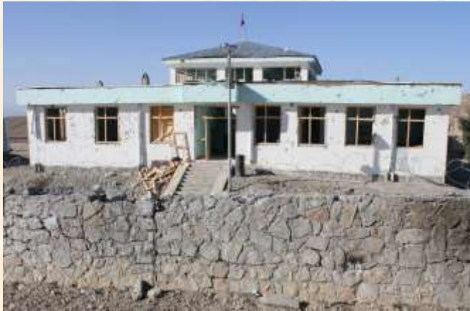
Oprava Okresního střediska poškozeného VBIED útokem v Khoshi
